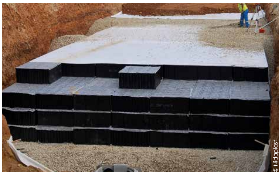
Le stockage temporaire des eaux pluviales, à travers un bassin d'infiltration et/ou de rétention, permet d'éviter un rejet trop important vers les réseaux traditionnels lors de fortes précipitations. Ici, un ouvrage, réalisé avec des blocs alvéolés empilables, enveloppés dans un géotextile poreux.
